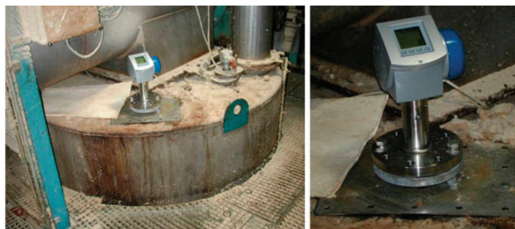
Aplicação de medição de nível em silo de alta temperatura com tecnologia radar
