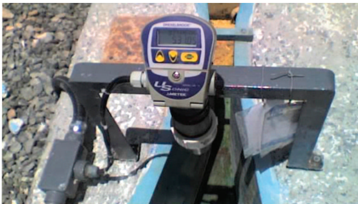
Aplicação de medição de vazão em calha Parshall com medidor de nível ultrassônico
